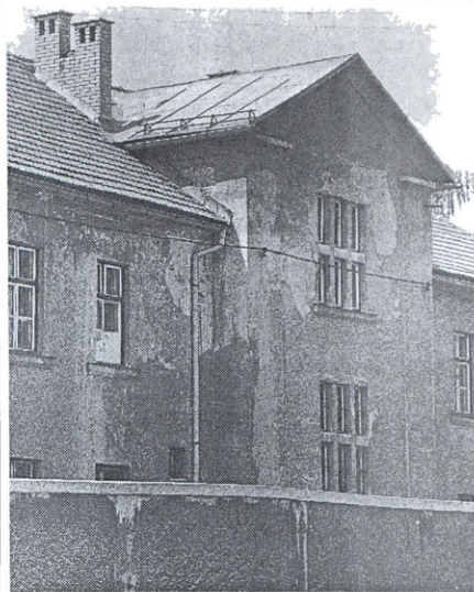
PODRTIJA OB MASARYKOVI CESTI – Razbita okna, uničena vodovodna in električna napeljava, poplavljene kleti in mine so ostanki nekdanjih vojašnic, ki pa so še vedno skrbno varovane. Obrambno ministrstvo je januarja izjavilo, da je to »velik družbeni strošek«, tako imenovane prostorske bele lise v Ljubljani se očitno počasi »barvajo«, saj gre barantanje s prostorom med državno in mestno oblastjo, kot kaže, h koncu. (Foto: Igor Modic)
